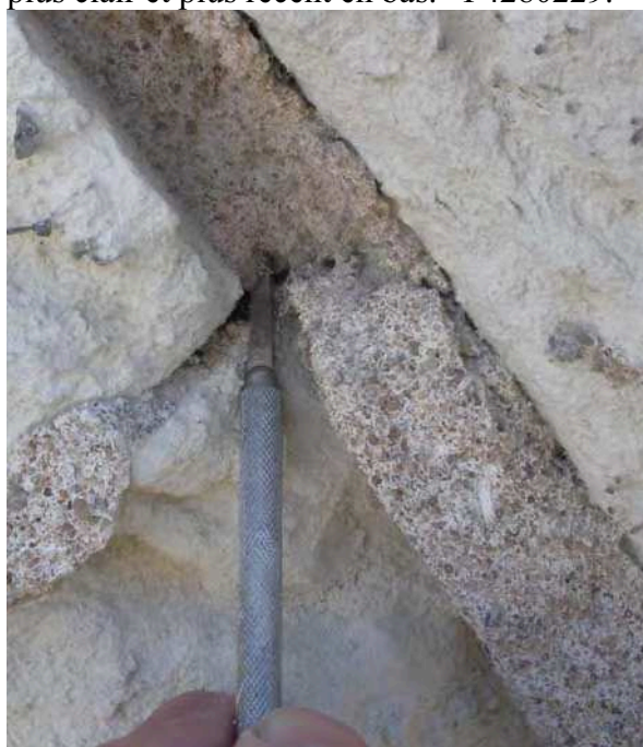
27. ↓ Portail ouest, voussure, 3 ème rouleau nord, coin supérieur du premier petit claveau, deux mortiers de sable et chaux, dont rejointoiement plus clair et plus récent en bas. P4280229.
