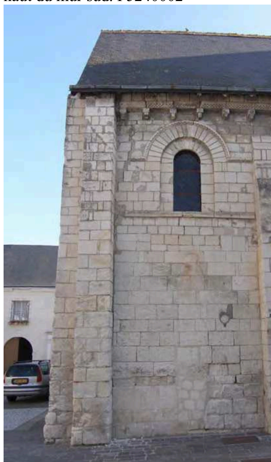
11. ↓ On retrouve la même lézarde, réouverte depuis un dernier rejointoiement, le long de la façade en haut du mur sud. P5240002
