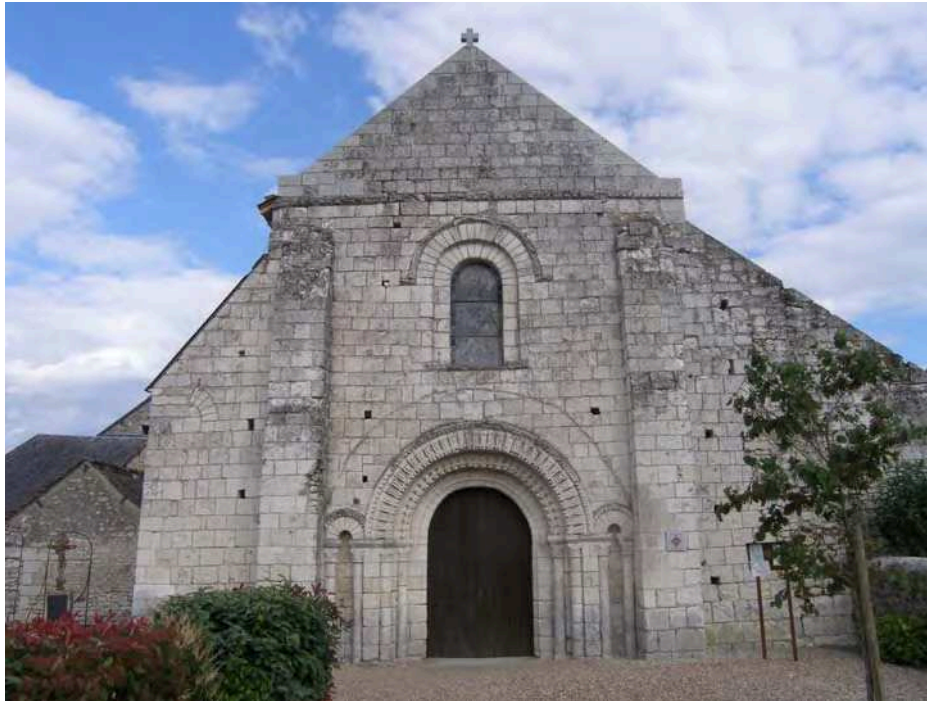
84. ← Façade occidentale de l'église de Tavant (37). L'état de conservation est globalement bien meilleur, en dépit de quelques problèmes de sels solubles notamment en bas à gauche de la voussure du portail. P5300107
