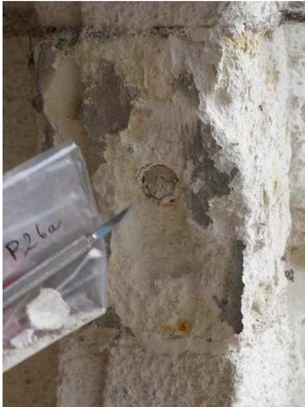
38. ← Portail ouest, voussure, 1 er rouleau, côté sud, 6 ème claveau, cheville de bois de fonction indéterminée (était couverte par un mortier analogue à celui de la figure 37 page 13, elle est donc antérieure ou contemporaine). P4280298
