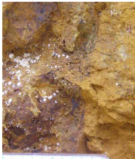
59. ↓ Détail grossi cinq fois environ : efflorescences blanches. L'analyse de P9 indique une forte teneur en nitrate et chlorure, une faible teneur en sulfate. P4200103
