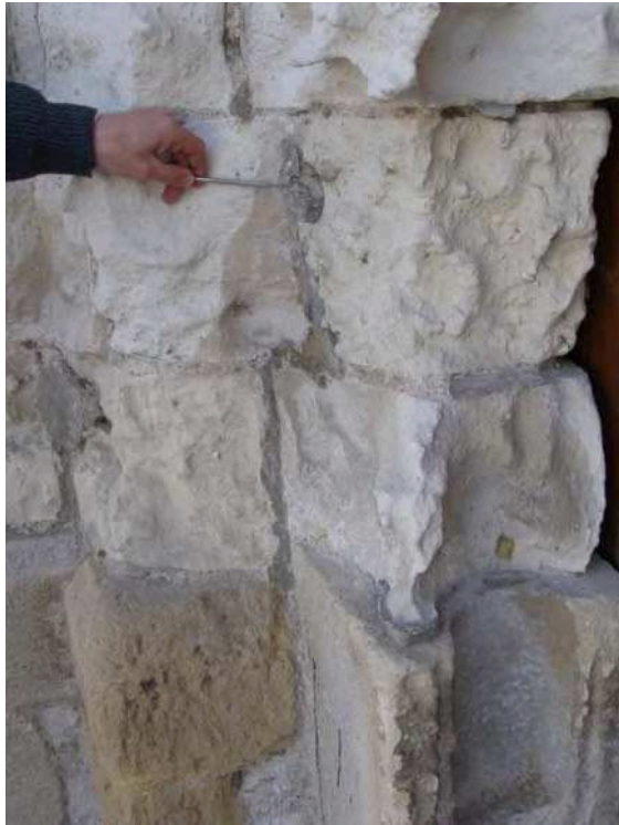
47. ← Portail ouest, ébrasement nord, tuffeau rongé par une désagrégation superficielle pulvérulente évoluant très rapidement. Le scalpel en haut pointe le recul du tuffeau depuis le dernier rejointoiement à base de ciment. P4200052
