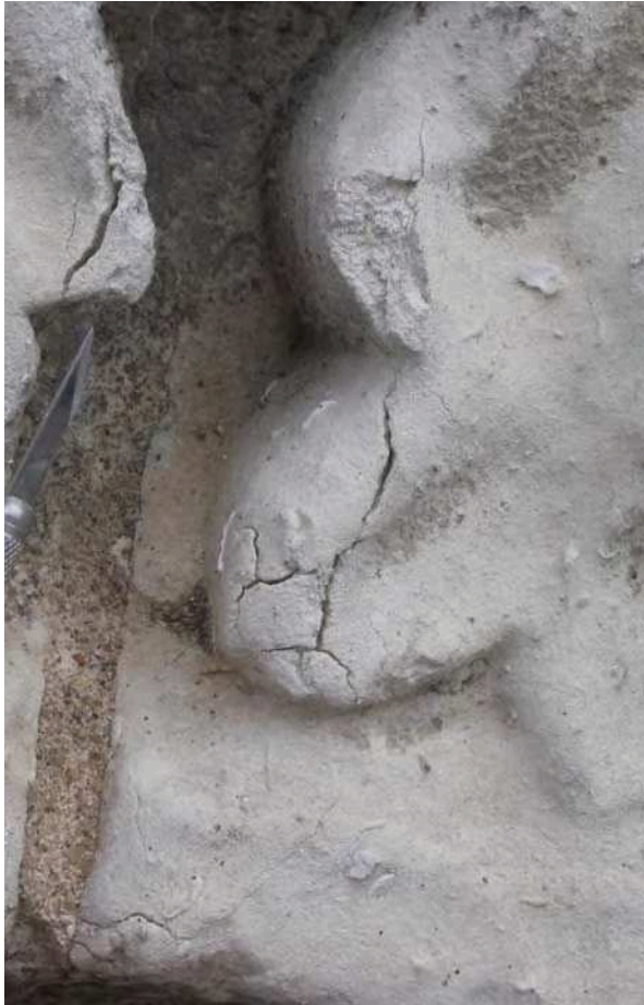
50. ← Portail ouest, voussure, 3ème rouleau, côté nord, 14ème claveau, angle inférieur gauche, grandeur nature: fissuration superficielle et désagrégation liée aux sels solubles, détail ci-dessous. P5150032
