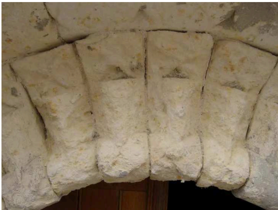
57. ← Portail nord, voussure, 1 er rouleau : les deux types de désagrégation sont ici à l'œuvre : désagrégation superficielle évoluant rapidement et désagrégation profonde. P5300071
